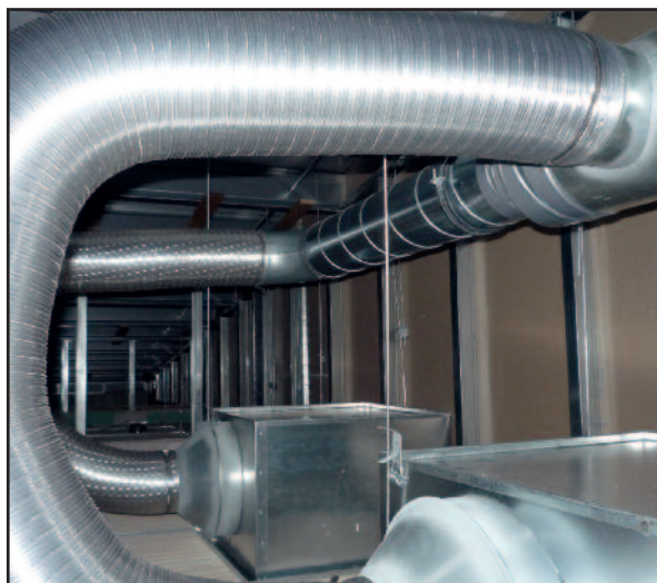
Réseau de ventilation réalisé sur mesure
