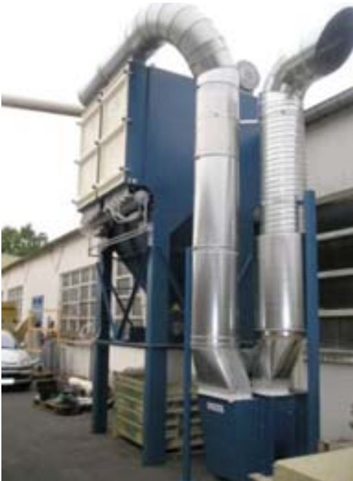
Dépoussiérage dans une fabrique de plaques, feuilles, tubes et profilés en matière plastique. Dust control in plastic profile and tube manufacturing plant.
