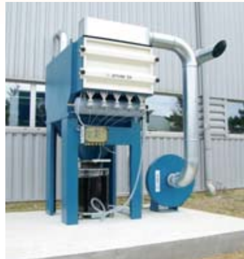
Dépoussiérage dans une fabrique de savons, détergents et produits d'entretien. Dust control of production line of soap and cleaning products.
