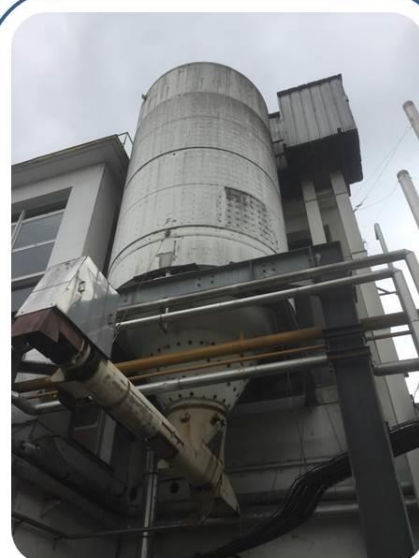
(x1) : Silo à drêche avec vis de décharge
