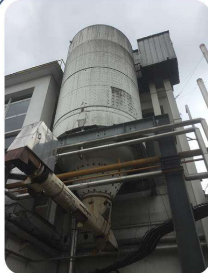
(x1) : Silo à drêche avec vis de décharge
