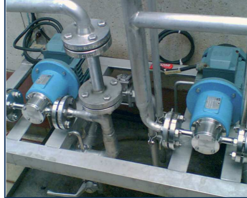
Pompes VA en Incoloy 825 pour dosage d'acide sulfurique
